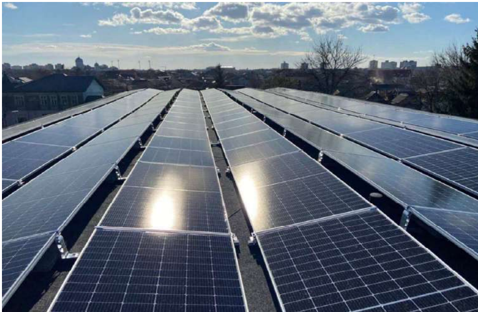
Instalație panouri rooftop în cadrul proiectului Restart Solar la sediul ROMCARBON din Buzău
