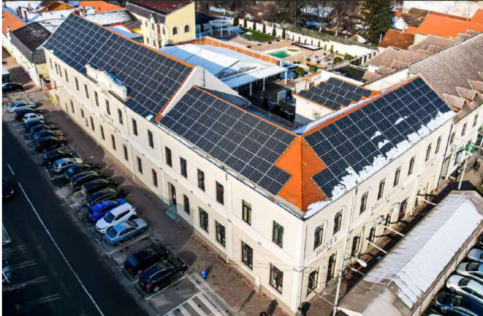
Instalație panouri rooftop prin proiectul Restart Solar la Hotel Bellavista din localitatea Deta jud.Timiș
